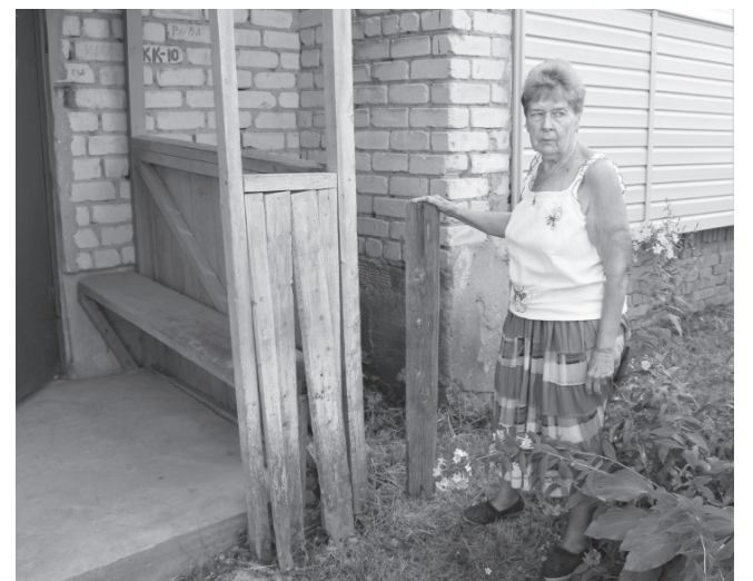
На фото: аварийное крыльцо
