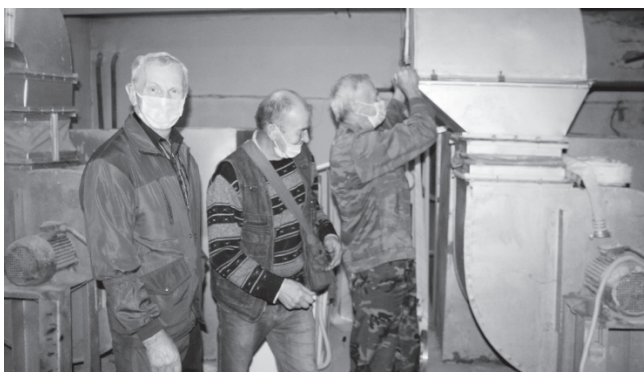
На фото: во время проверки радиационного укрытия
